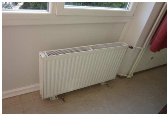
Slika 4: Ploščati radiator v učilnici: V&N z navadnim ventilom
