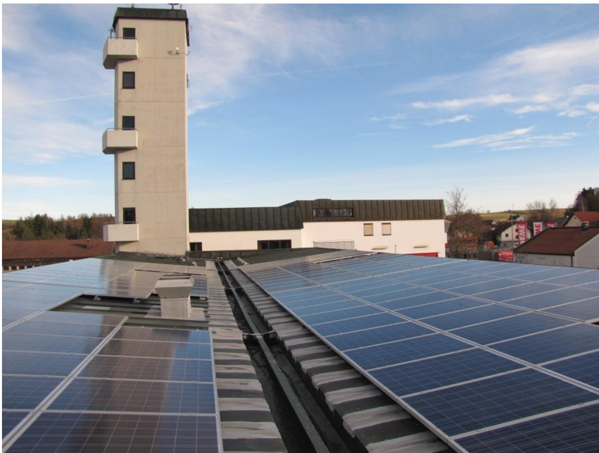
Image 3: Photovoltaic plant on the firebrigade roof, Source: Bürgerenergie im Landkreis Pfaffenhofen a. d. Ilm eG
