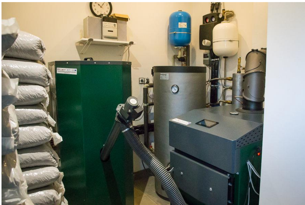
Image 26: Biomass boiler, Source: Urząd Gminy Niemce
