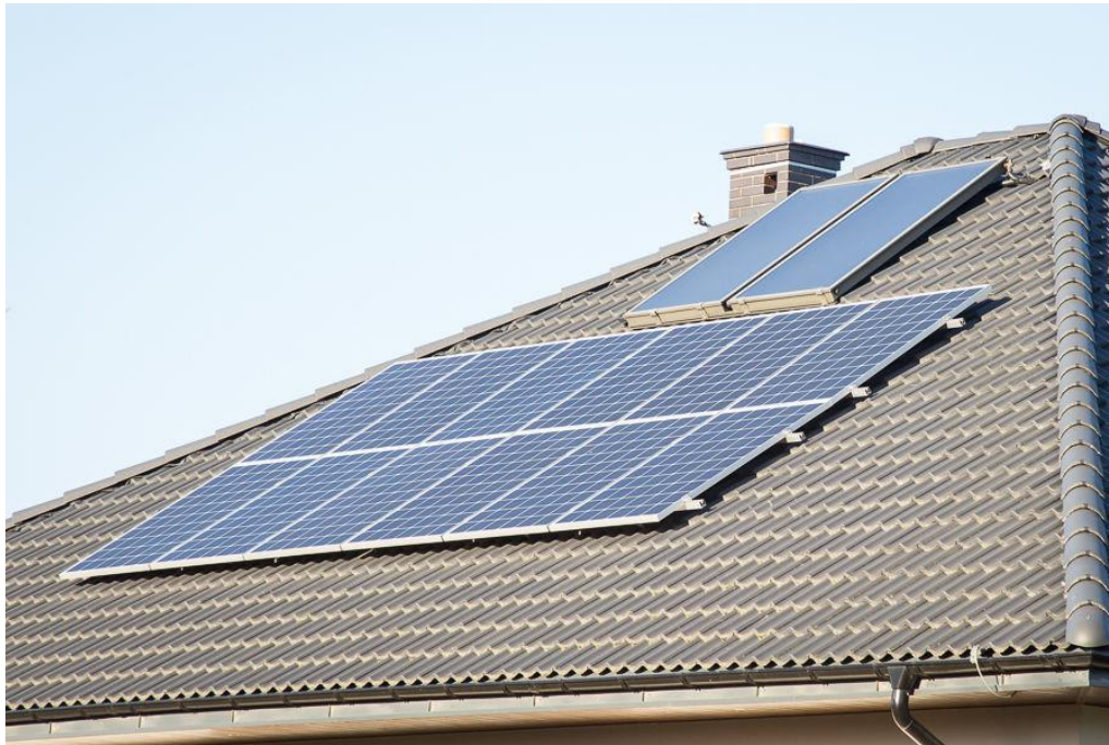
Image 25: Rooftop PV installation, Source: Urząd Gminy Niemce
