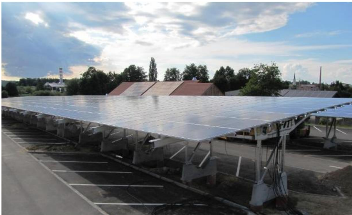
Image 2: Solar car port in Pfaffenhofen, Source: Bürgerenergie im Landkreis Pfaffenhofen a. d. Ilm eG
