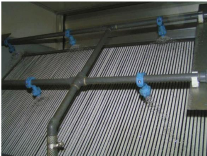
Adiabatyczne chłodzenie powietrza wylotowego, Instytut Fizyki Uniwersytetu Humboldta, Adlershof, Berlin (Zdjęcie: M. Schmidt)
