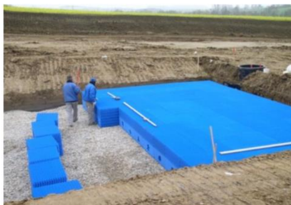
Rów infiltracyjny z materiałem wypełniającym (Zdjęcie: Sieker)
