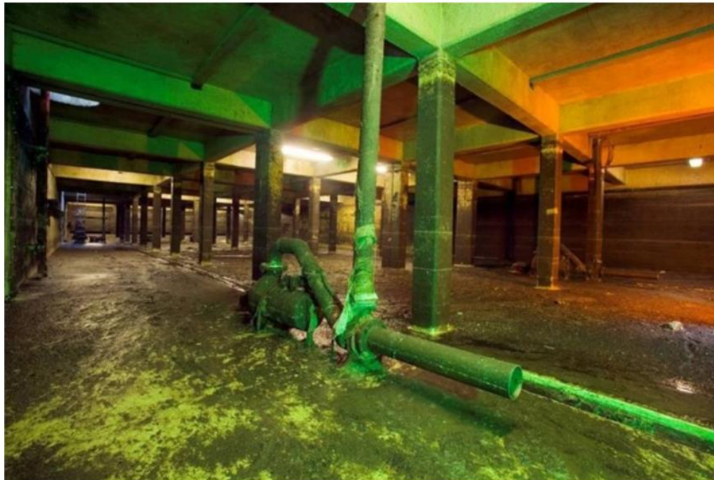
Zbiorniki przelewowe wody mieszanej w Berlin-Wedding (Zdjęcie: BWB)
