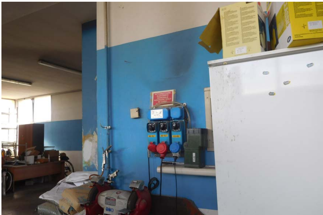
Foto 8: Gli impianti elettrici e di compressione aria da dismettere
