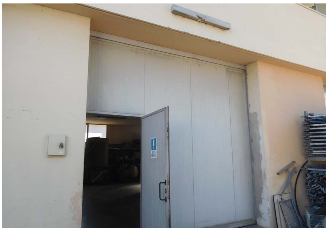
Foto 4: Serramento lato ovest principale da sostituire con vetrata
