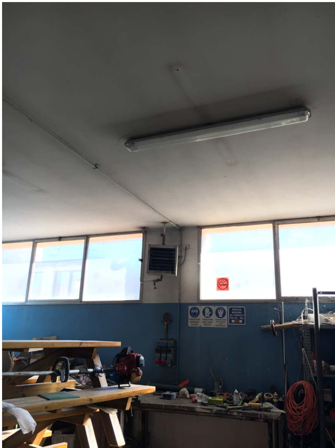
Foto 7: i serramenti, aerotermi e lampade da sostituire
